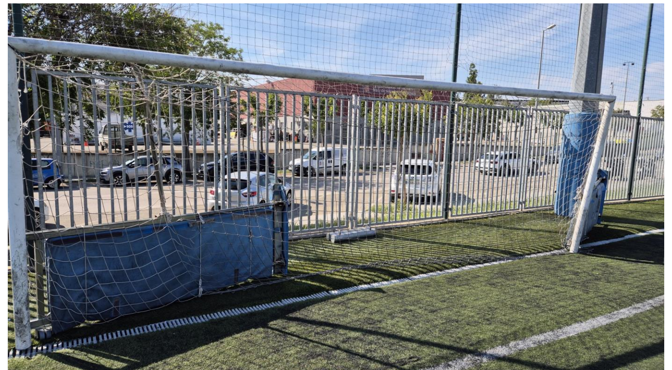
Detall de l'estat de les porteries i les proteccions
