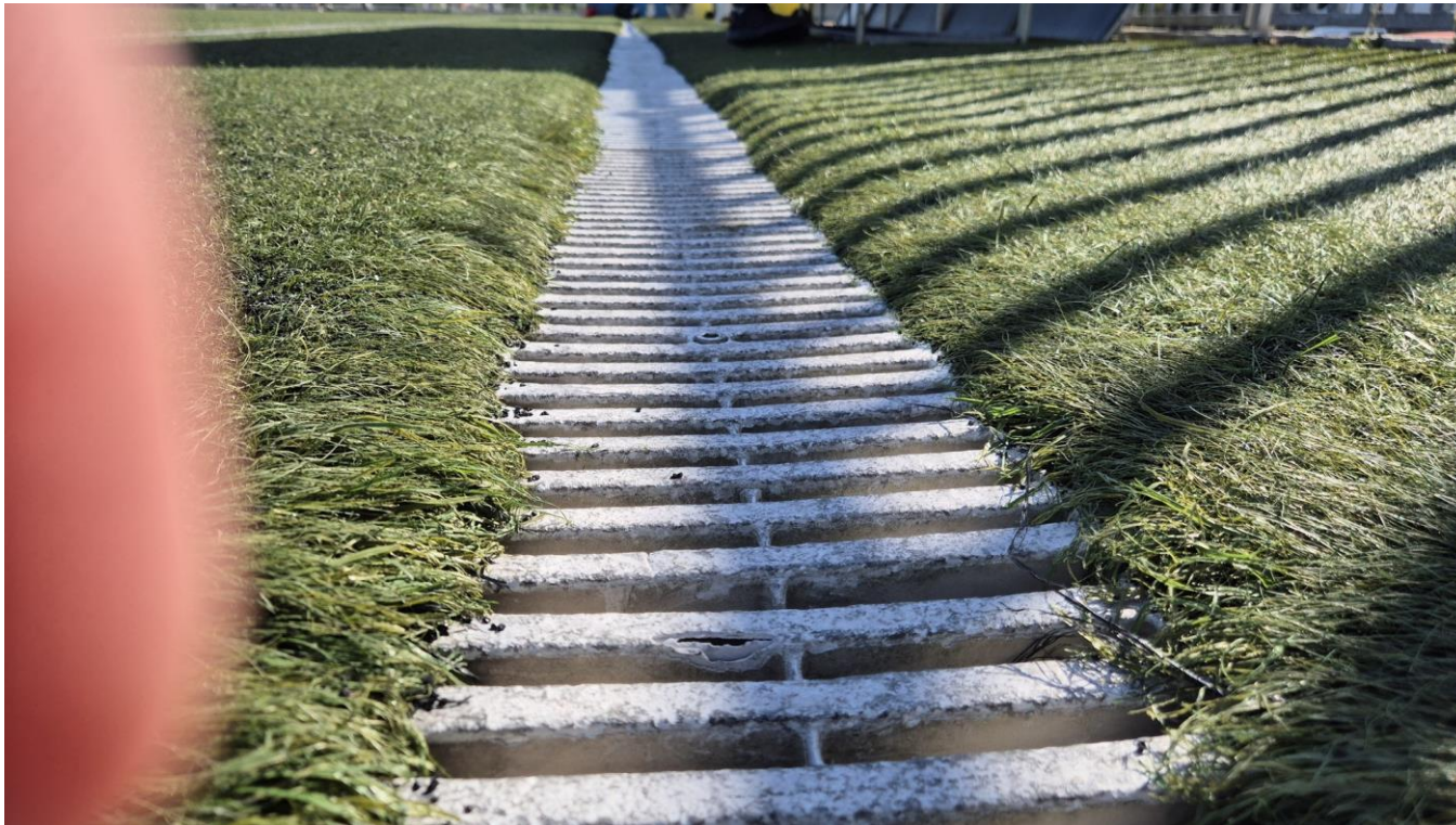
Detall de l'estat de la canaleta
