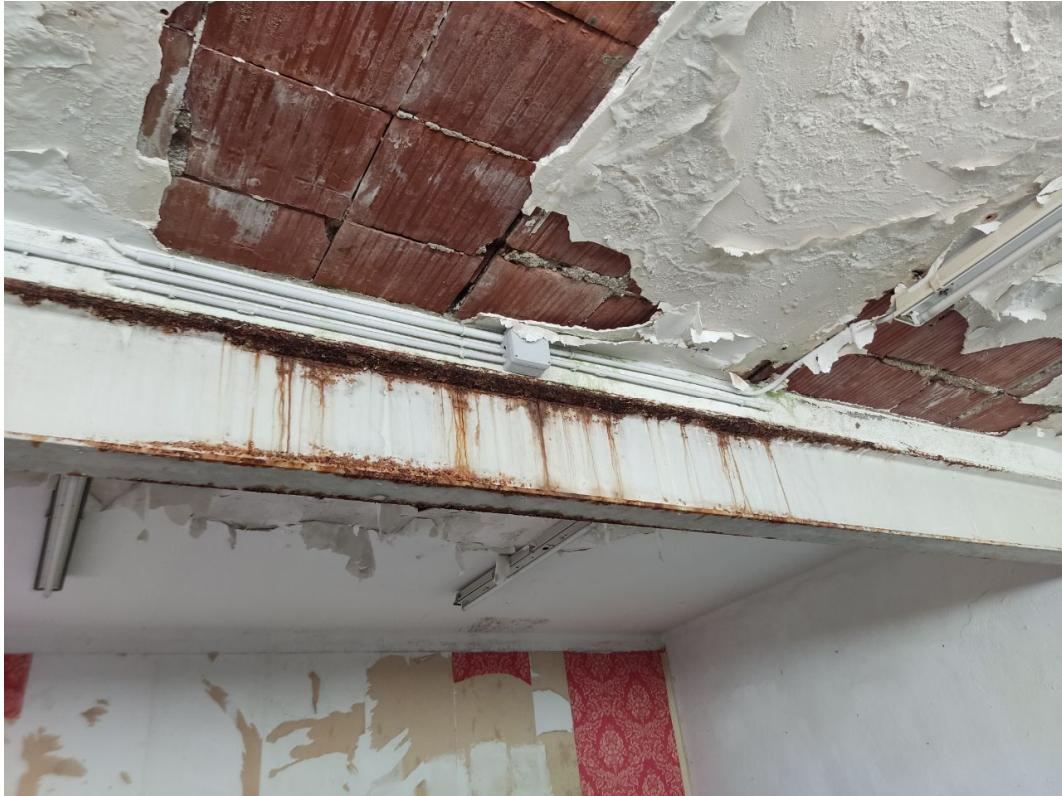
Jàssera amb senyals d'oxidació
