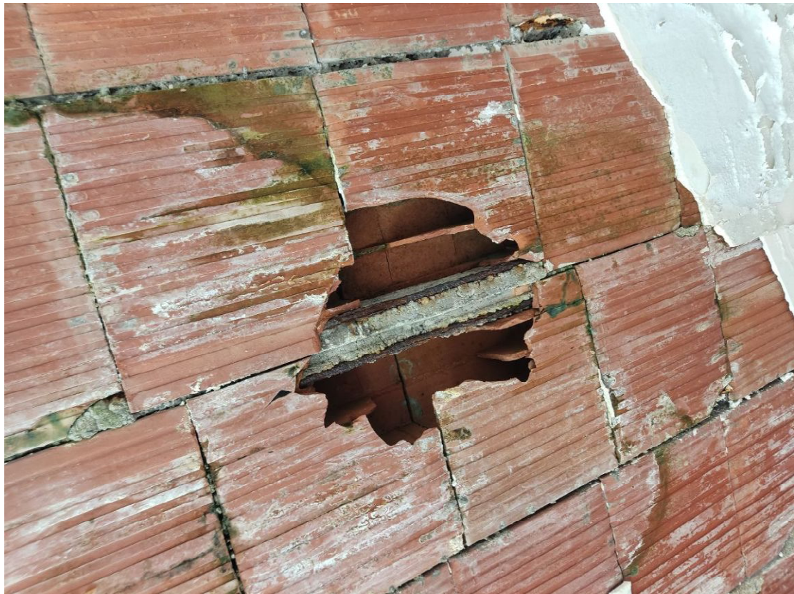
Cala a la bigueta amb oxidació de l'armat
