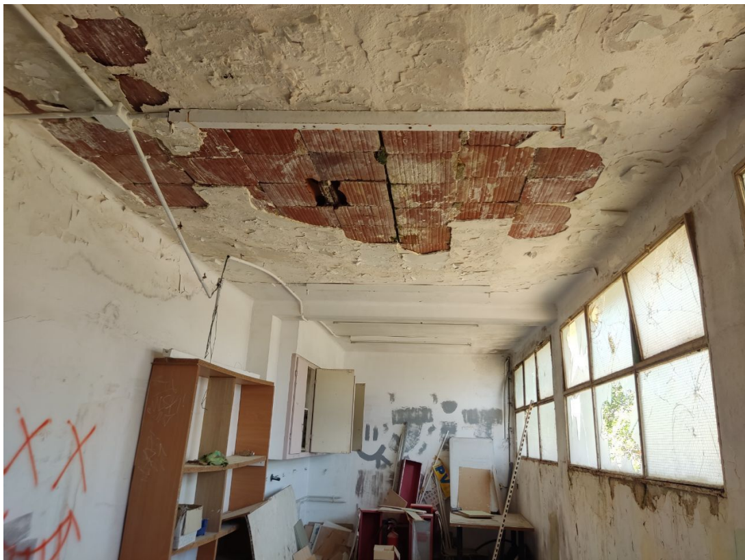
Forjat afectat per filtracions d'aigües pluvials
