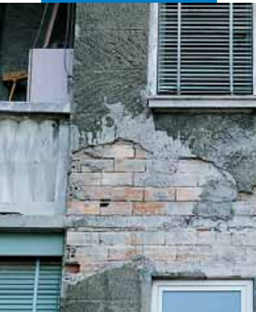
Edificio degradado que precisa de una reparación
