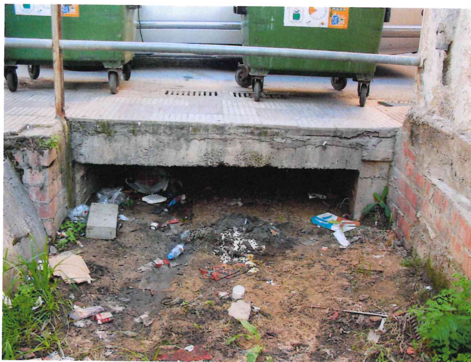
Sortida de la canalització de les aigües pluvials del Carrer Illes Balears
